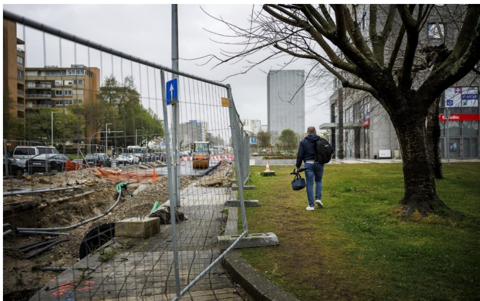
Foto 5 - Percurso utilizado pelos peões face à inexistência de passeio no sentido ascendente da Avenida da Boavista, após a Rua Domingos Alvarez (28 março 2024).
