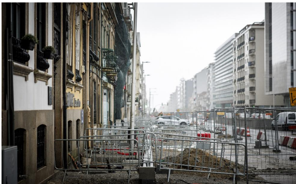
Foto 7 - Panorâmica da intervenção no sentido ascendente da Avenida da Boavista em frente à Casa da Música (28 março 2024).
