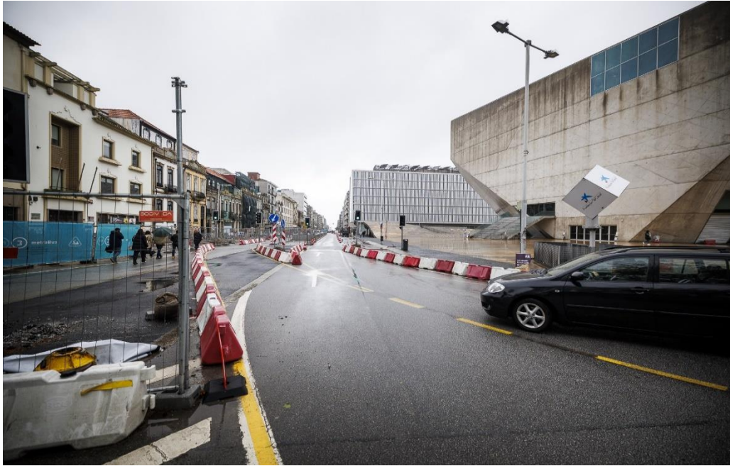
Foto 14 - Entrada na Avenida da Boavista com uma bifurcação sem indicação dos locais a que cada uma das vias acede (28 março 2024).
