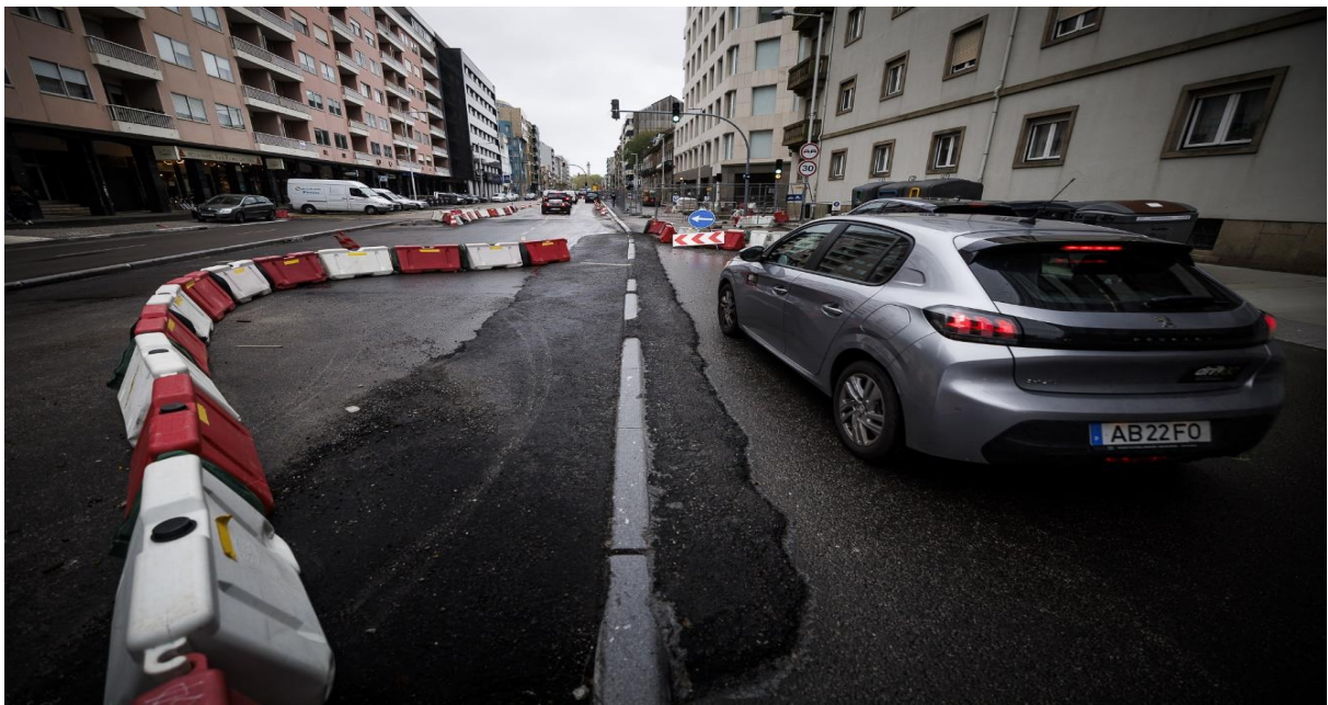
Foto 23 - Perspetiva mais distante da situação retratada na fotografia 22 (28 março 2024).
